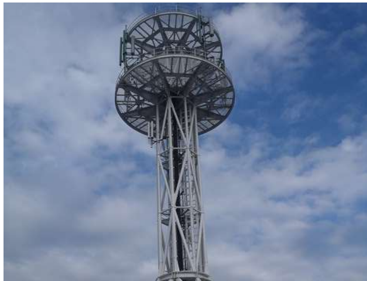
* 通信事業者等からの鉄塔の譲渡
